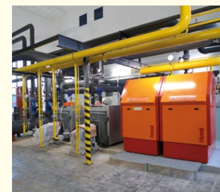
Nové vybavenie kotolne vo Vrakuni
